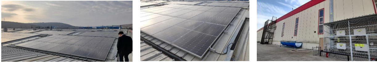
Resim 12: Catıya kurulan GES panelleri ve tesisin kuzeyine, dış cepheye konulan invertörlerin bazıları
